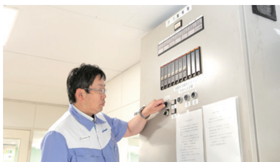
水素ガス漏れ検知器点検
