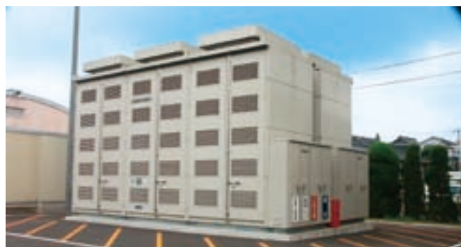
九州本社 NAS 電池
