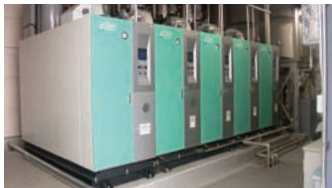
宇都宮工場天然ガス式ボイラー
