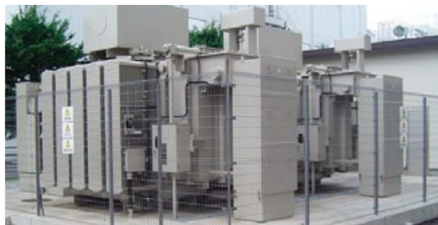
特高受電設備
