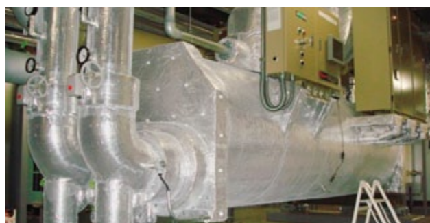
ターボ冷凍機
