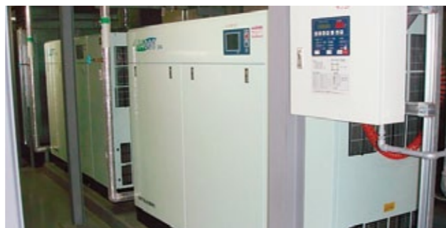
台数制御コンプレッサー
