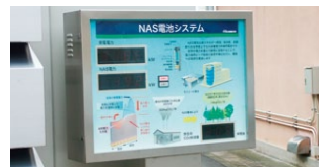
NAS 電池システム
