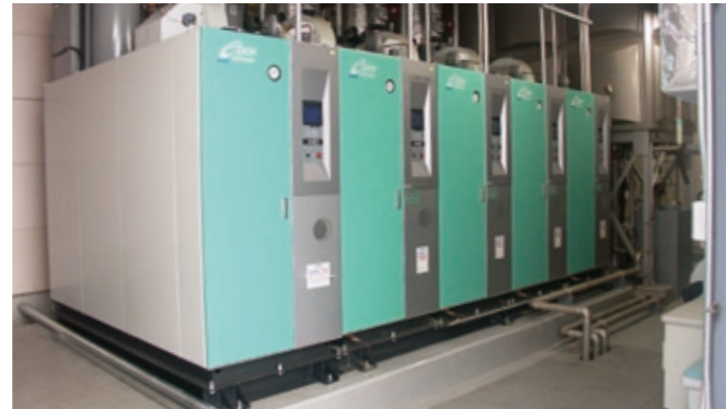
宇都宮工場天然ガス式ボイラー
