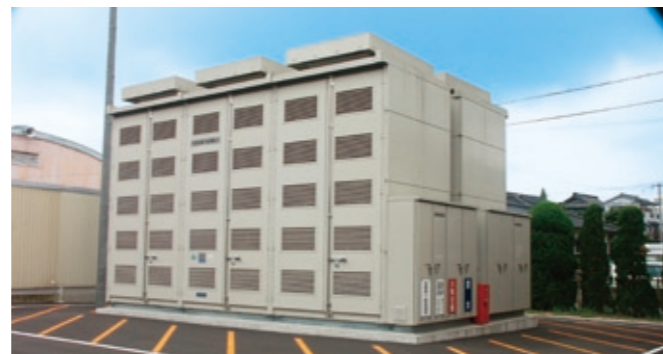
九州本社 NAS 電池
