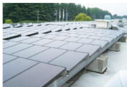
太陽光発電設備(宇都宮工場)
