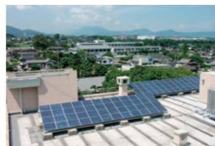
太陽光発電設備(鳥栖工場)
